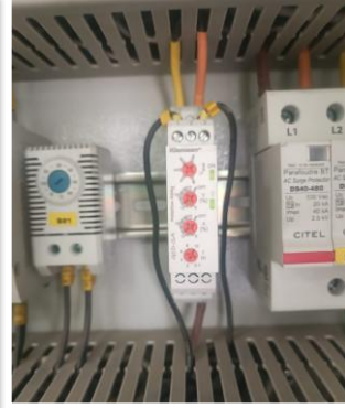
POZO Ciudad Del Sol: Se cambia vigilante de tensión, se deja conectado y probado.
