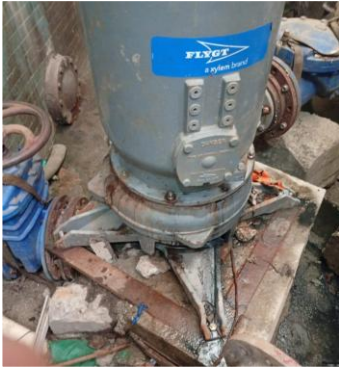
EBAR Rodadero: Se ajustó la tornillería de la boluta de la bomba 3, queda sin fuga.
