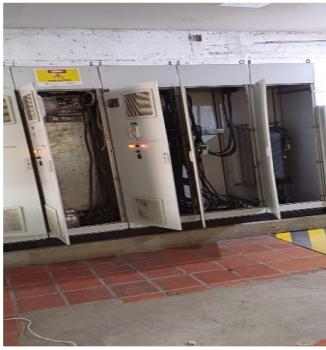
EBAR Norte: Se realiza limpieza a gabinetes de variadores y áreas de la estación.
