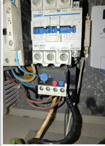
EBAP San José Del Pando: Corrección de breaker térmico disparado por temperatura.
