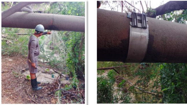
CORRECCIÓN DE FUGA LÍNEA DE 16" HF 13 DE ENERO DE 2026
