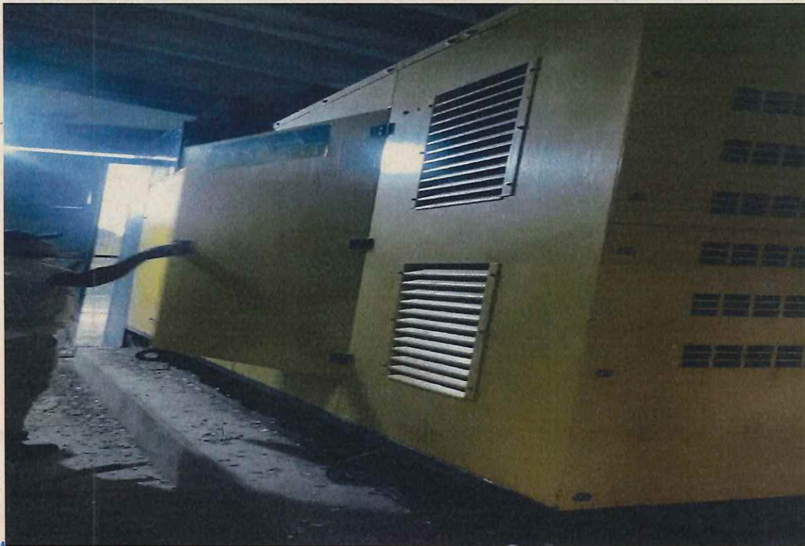
Generador fuera de servicio
