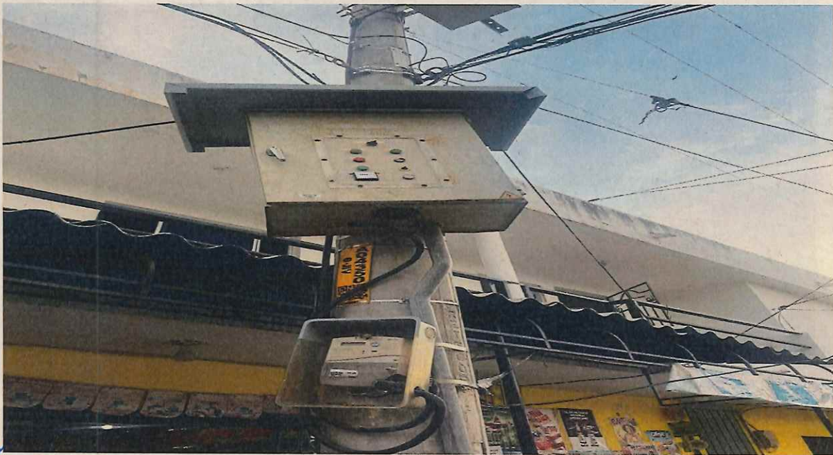
La caja eléctrica se evidencia inestable
