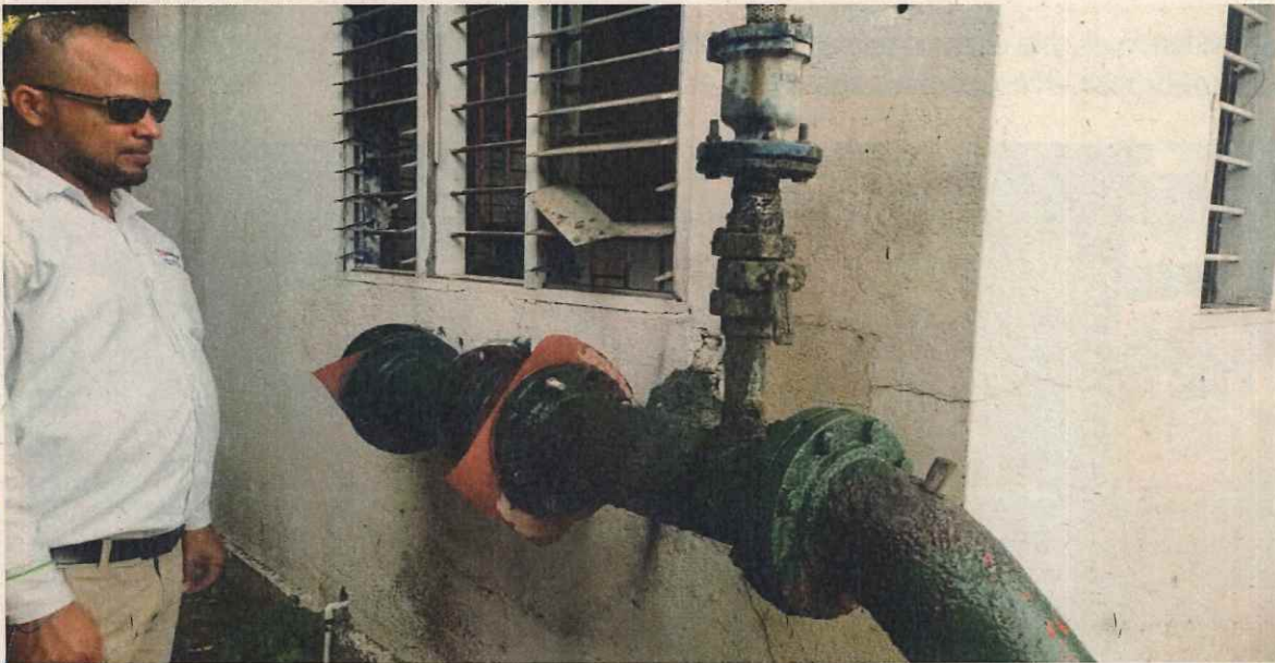
Línea de descarga en mal estado.
