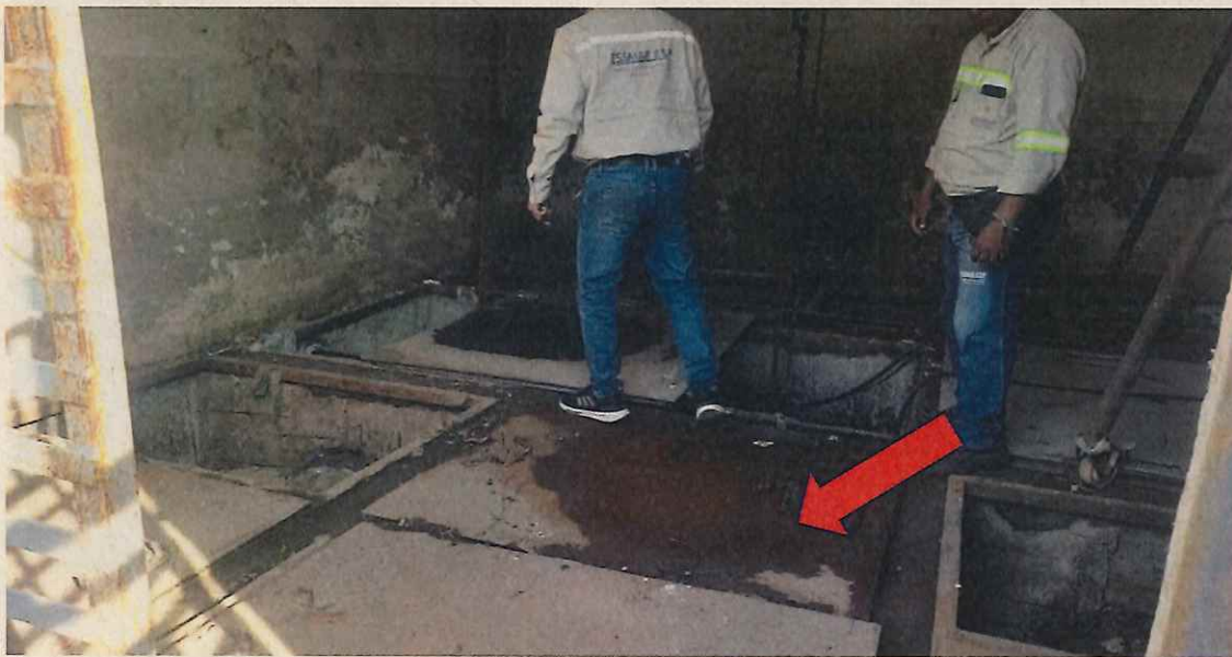
Tapas en mal estado
