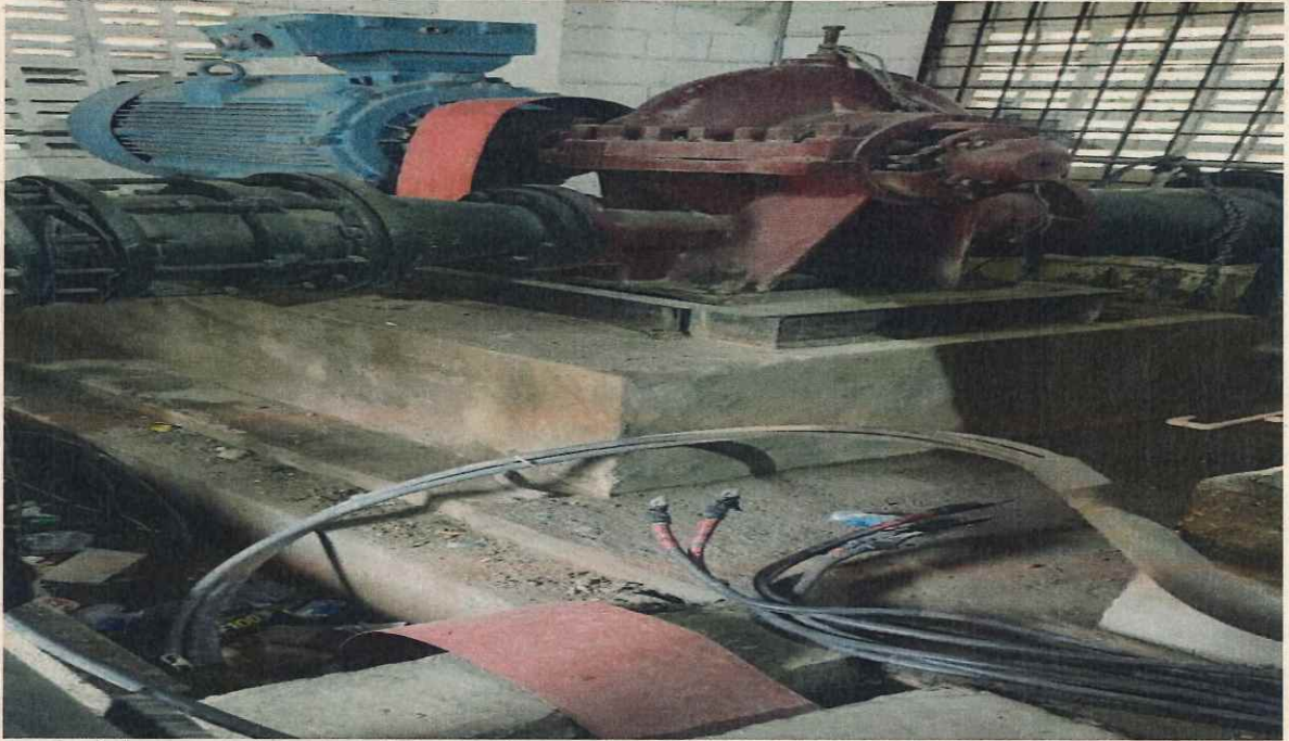
Bomba 1 desconectada, pero en buen estado
