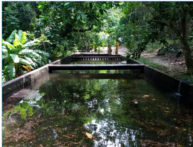
Ilustración 13. Desarenador 1 Río Manzanares.
