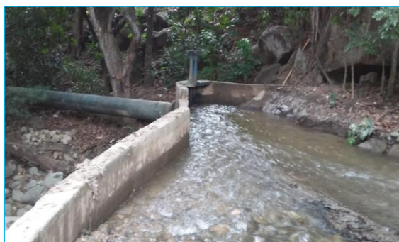
Ilustración 11. Captación 1 Río Gaira.
