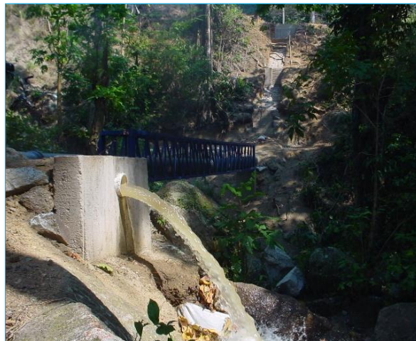
Ilustración 15. Desarenador Río Piedras.
