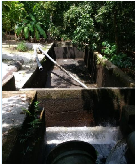
Ilustración 14. Desarenador 2 Río Manzanares.
