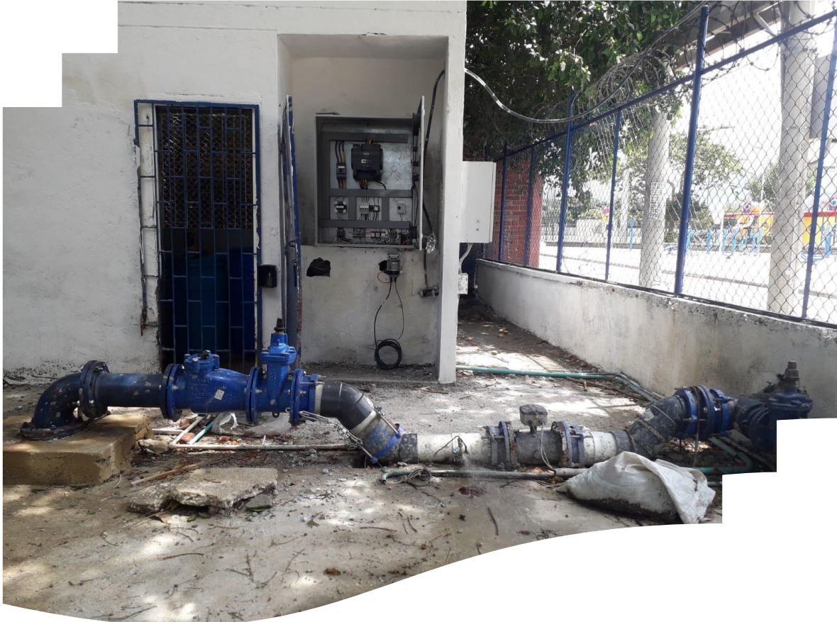
Ilustración 1. Pozo profundo de captación de agua subterránea.
